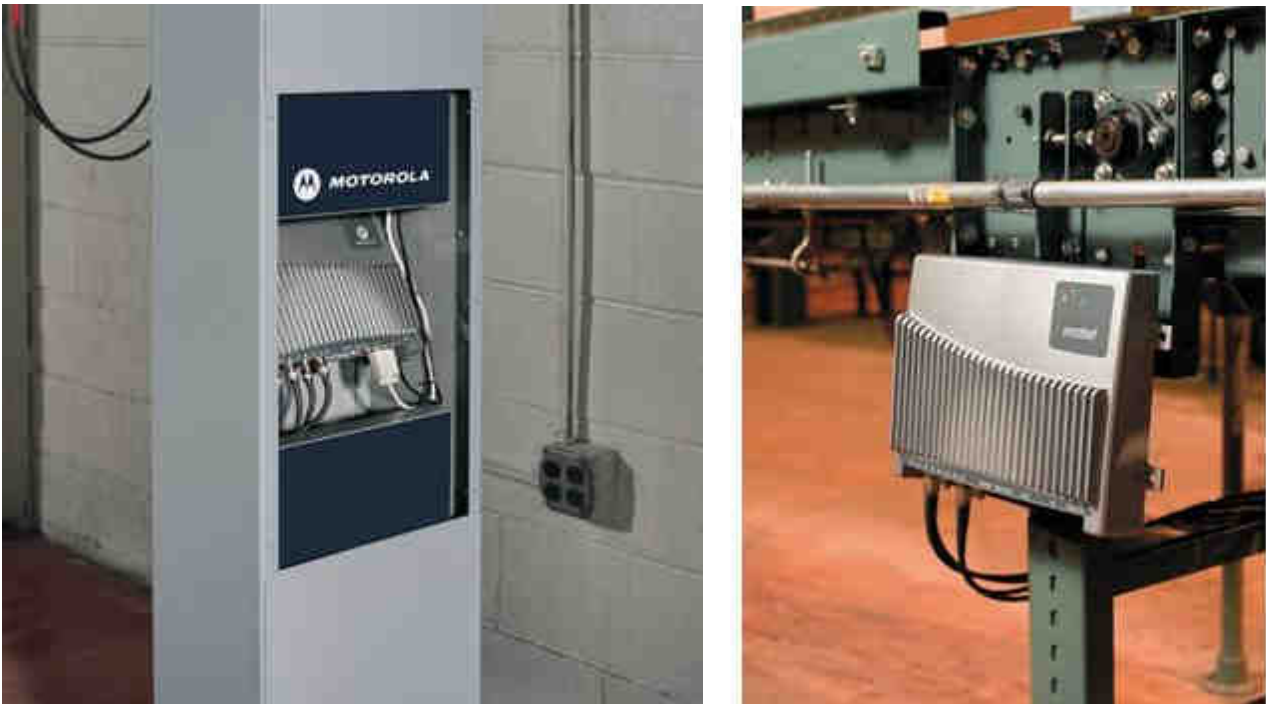
Рисунок 4.18 – Встановлений RFID зчитувач XR480
